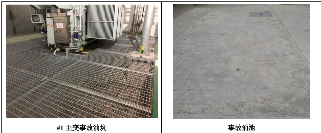
图 8-2 恒润环锻 110kV 事故油坑
